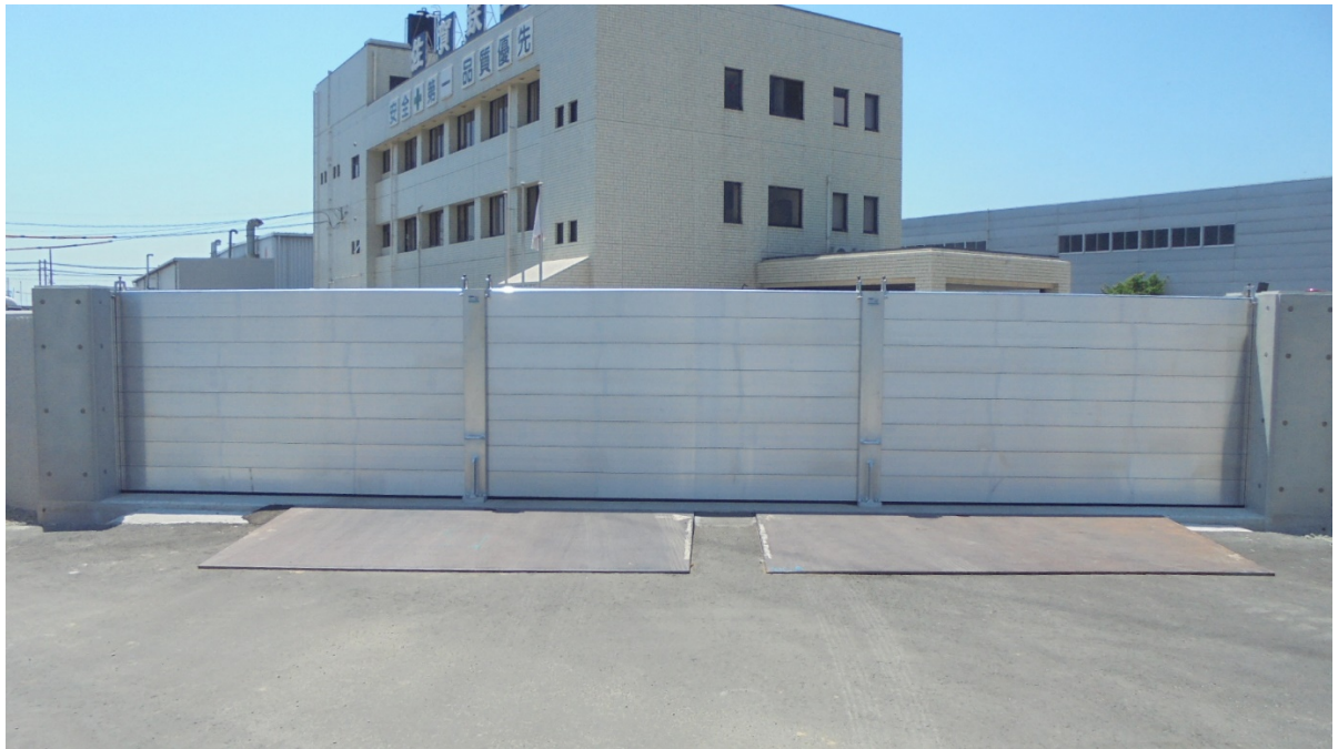
出入り口閉鎖状況
