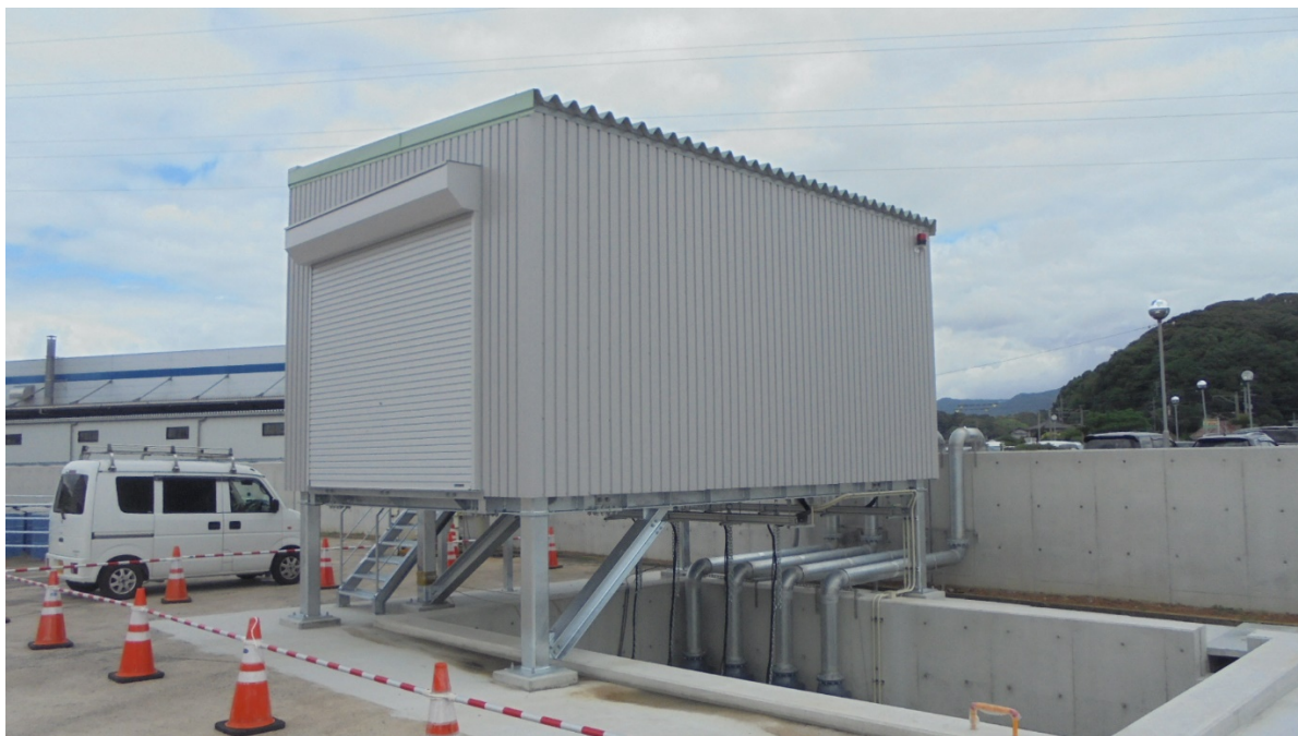
雨水槽・排水ポンプ
